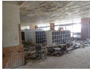
平成30年7月豪雨の被害
