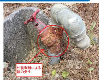
老朽化した給水栓(例)
