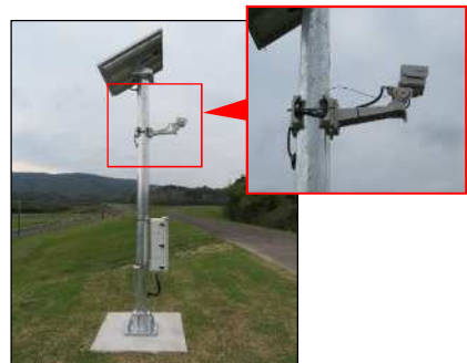
簡易型河川監視カメラ
