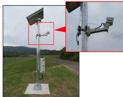
簡易型河川監視カメラ
