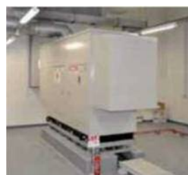
非常用発電設備のイメージ
