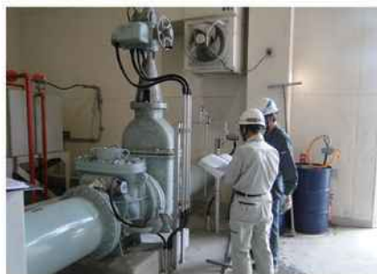
○機能診断（加圧ポンプ）
