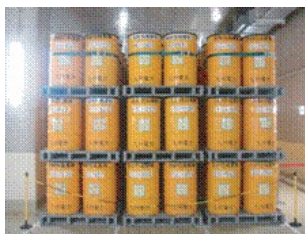
固体廃棄物貯蔵庫での保管状況
