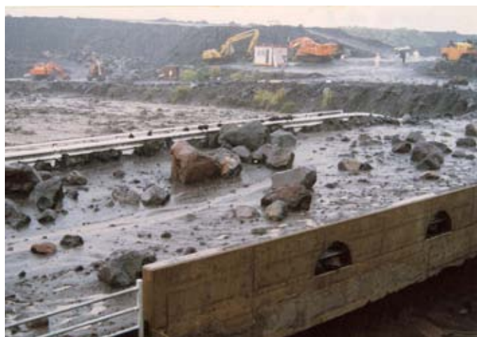
図 3-4-20 野尻橋の被害の様子（昭和 58(1983)年 9 月 21 日）
