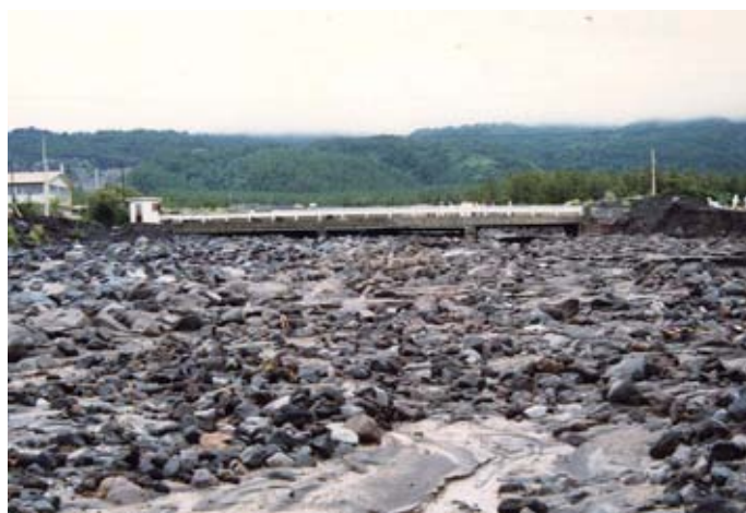
図 3-4-19 野尻橋の被害の様子（昭和 58(1983)年 6 月 21 日）
