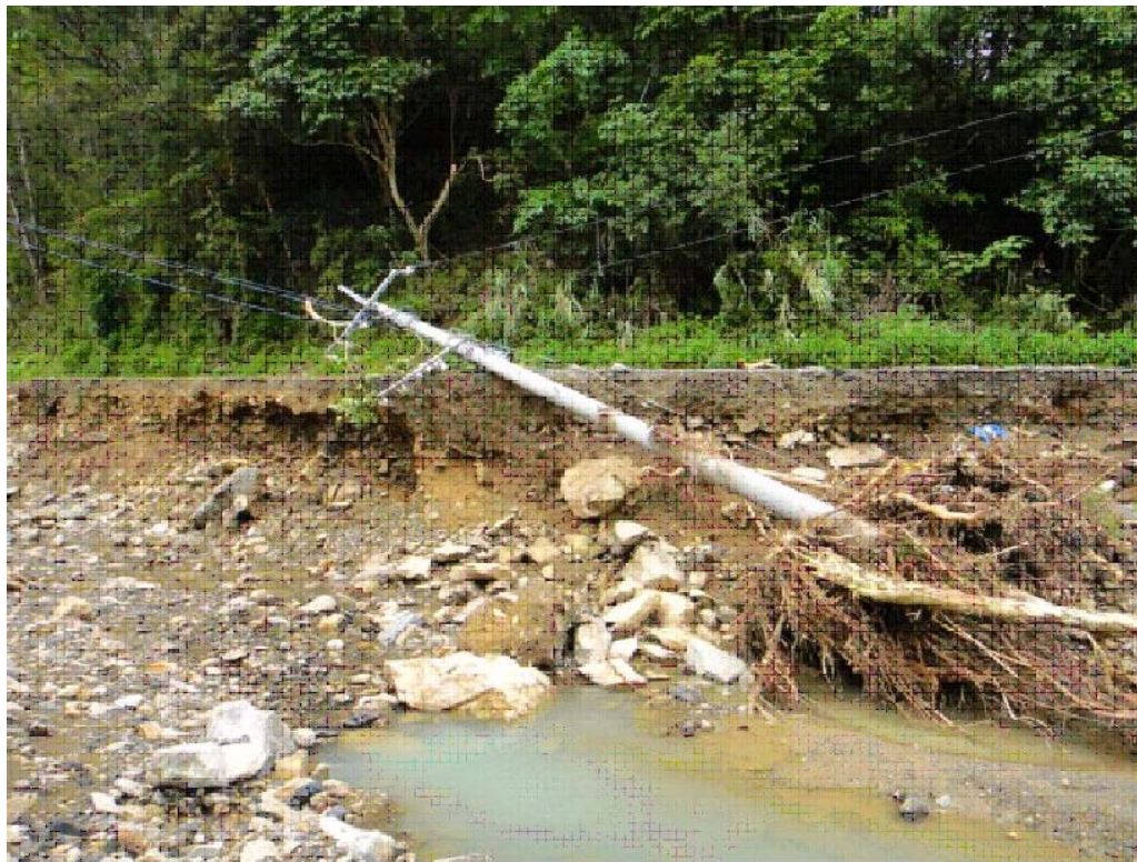
配電設備被害状況(奄美市名瀬芦花部)
