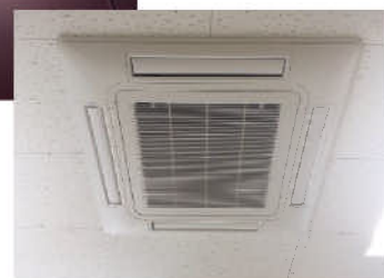
【設備機器の例（代表的な機器を撮影）】
