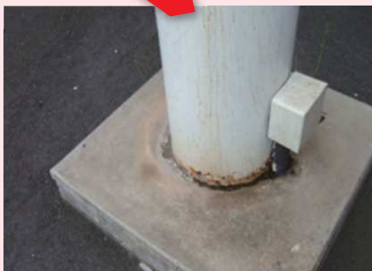
ポールの根元にサビが発生
