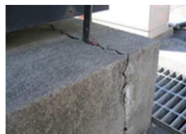
看板基礎のひび割れ
