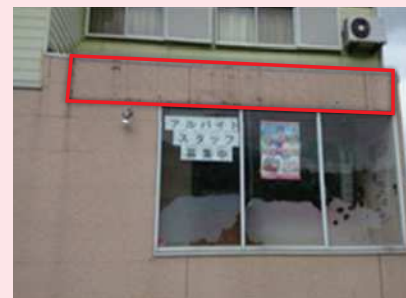
落下した後の壁面
