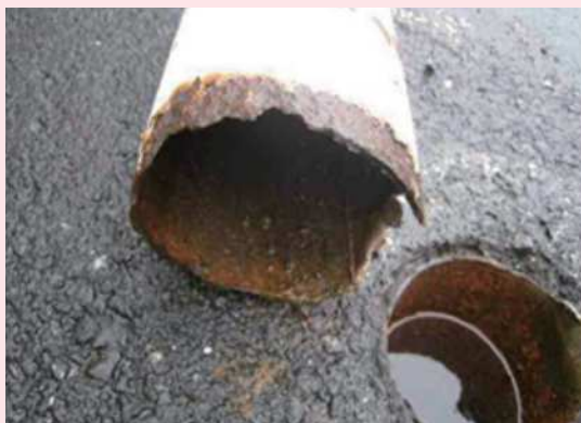
ポールの根腐れによる倒壊
