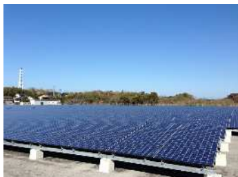
図 薩摩川内市内の太陽光発電所 出典：次世代エネルギーウェブサイト
