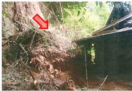
始良市蒲生町 火の宇都3地区 がけ崩れ状況
