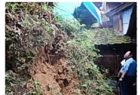
始良市蒲生町 漆地区 がけ崩れ
