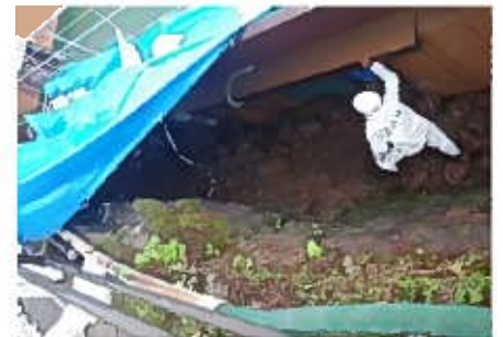
南さつま市坊津町 中坊2地区 がけ崩れ
