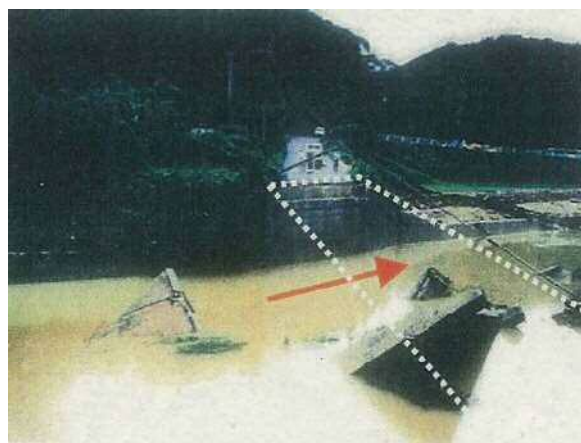
榕城橋流失(3k365付近)
