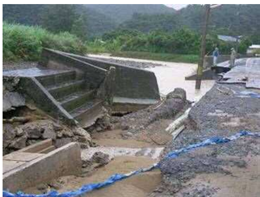
写真 2-1 H22.10 洪水による被災状況 (戸口川破堤)
