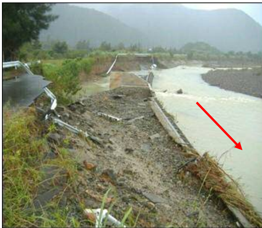
写真 2-1 H22.10 洪水による被災状況
