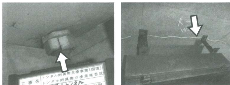
(a) ナットの亀裂
