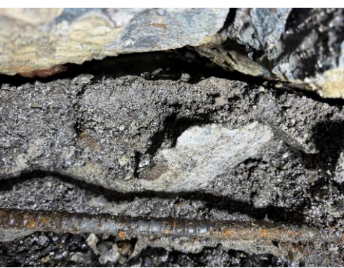
インバートコンクリート間の堆砂状況
