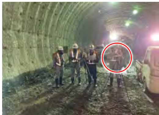
【会議用スピーカーの設置（現場側）】
