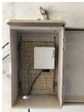
【坑内にWi-Fiルーターの設置(@100m)】
