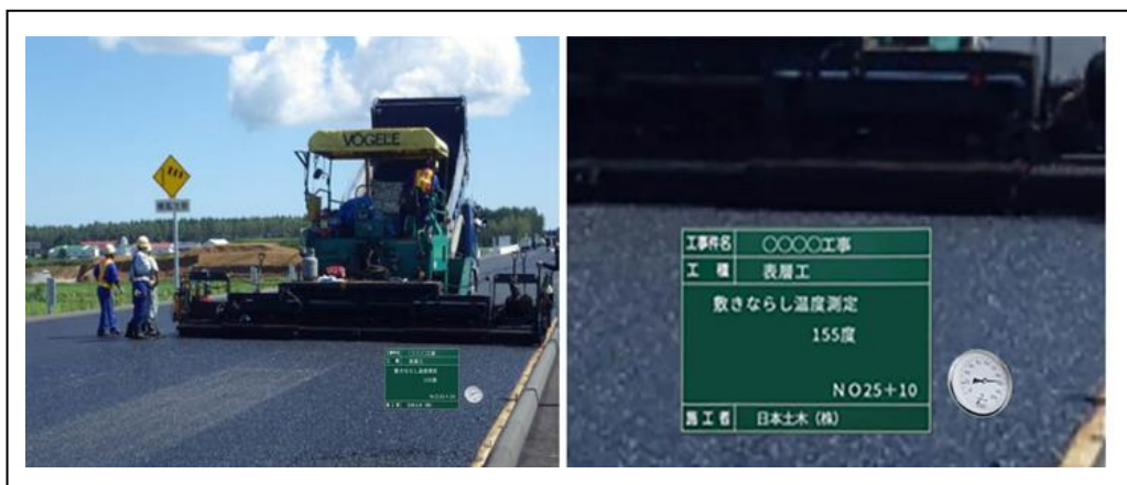
(写真Ⅱ-6)アスファルト合材に関する品質管理試験全景写真(左)と部分図(右)
