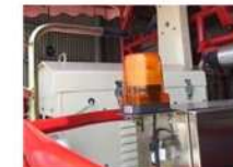
◆緊急停止用送受信アンテナ (非常時にエンジンを遠隔操作で停止)
