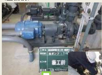
【中原加圧機場（枕崎市）】 （整備前）
