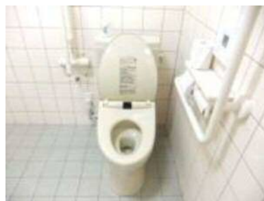
可動式手すり
