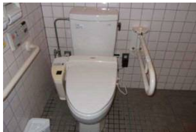
可動式手すり
