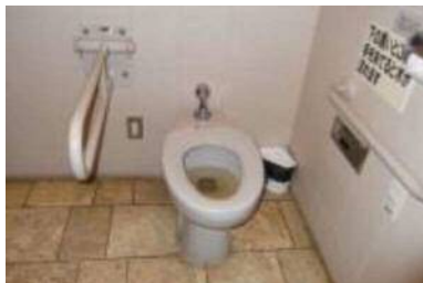
可動式手すり
