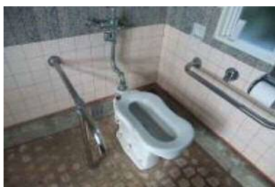
固定式手すり
