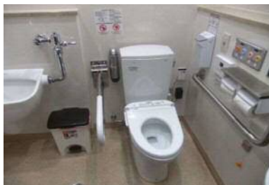
可動式手すり
