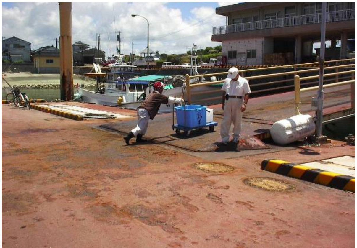
浮棧橋の老朽化により車の出入りが不可能である
