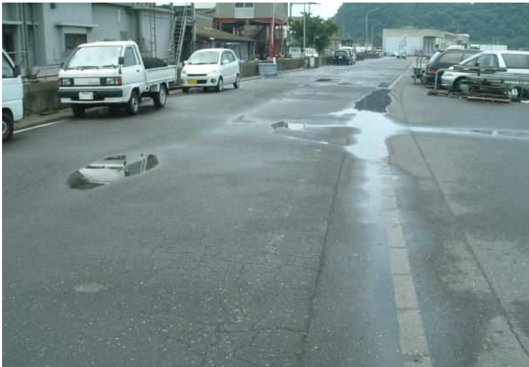
大型輸送車の往来が激しく、路面に不陸が起きている。水溜まりは衛生上も好ましくない状況。 平成16年7月撮影
