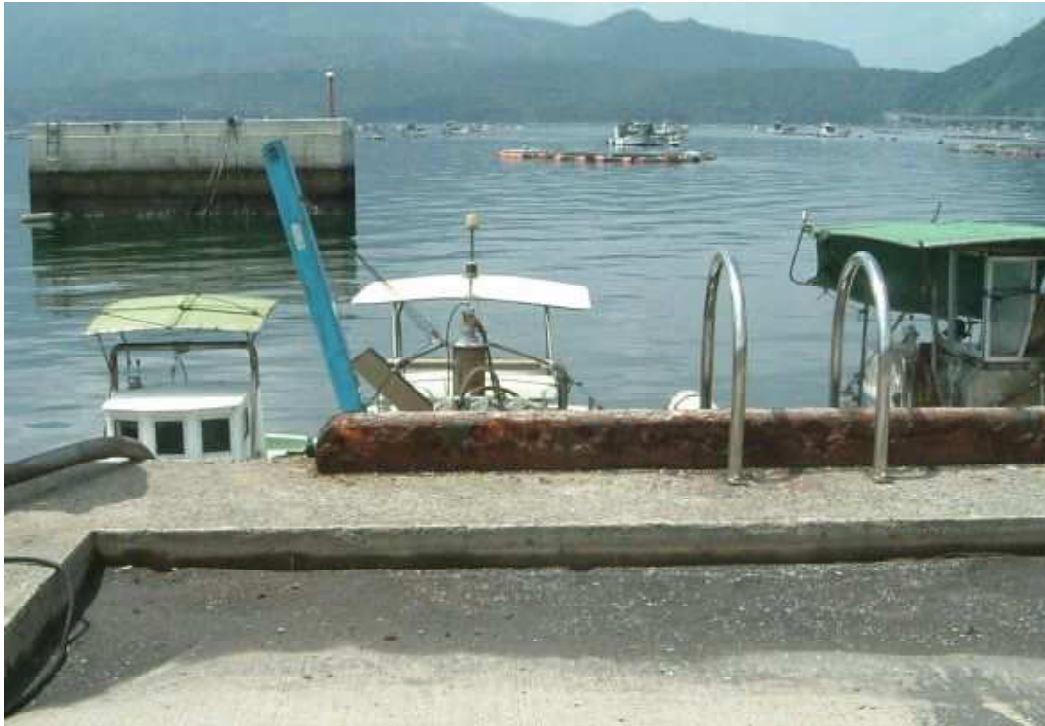
岸壁や物揚場に段差が生じており、漁船への乗降や資材の積下ろしの際に転倒するなど危険な状況。 平成16年7月撮影
