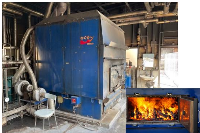
【木質バイオマス（薪）ボイラー】
