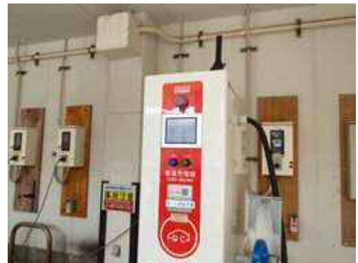
電気自動車充電設備
