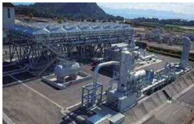
山川バイナリー発電所 (写真協力：九電みらいエナジー(株))
