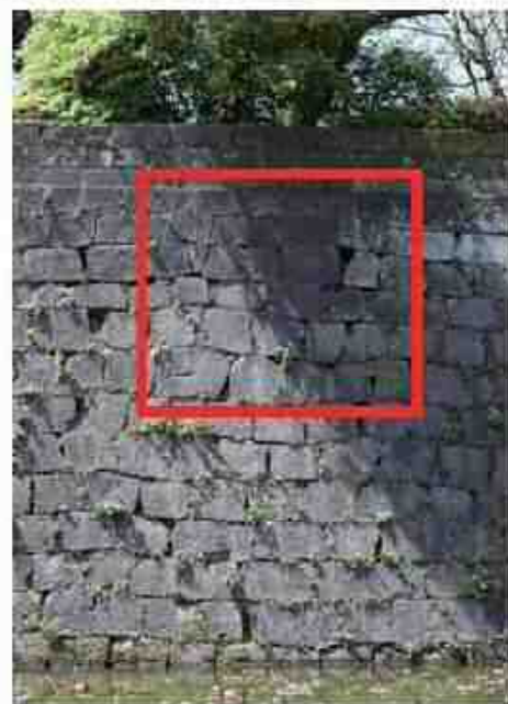
写真-13 孕み出し
