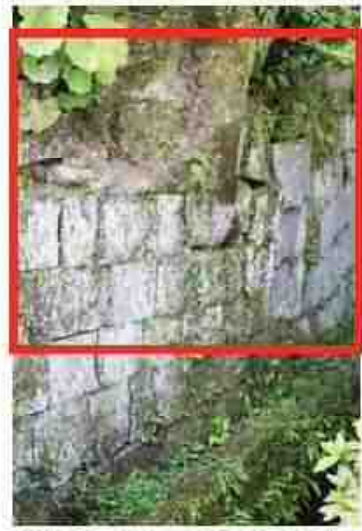
写真-9 巨木が石垣上にみられる
