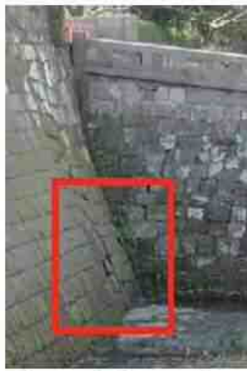
写真-8 下部が孕んでいる (写真は「鶴丸城石垣現況基礎調査業務委託」のものを使用)
