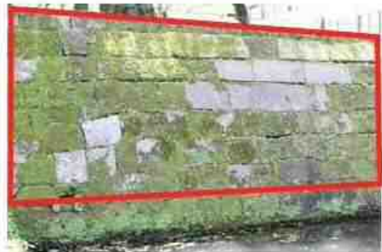
写真-11 石垣天端の傾きと孕み
