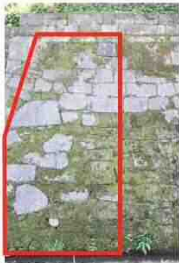
写真-7 打込み部分が孕んでいる
