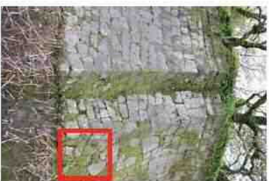
写真-6 孕み出し
