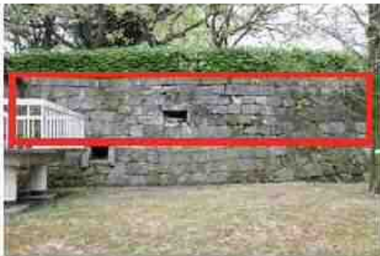
写真-10 石垣表面のズレがみられる
